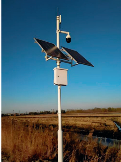
一体化视频监控
