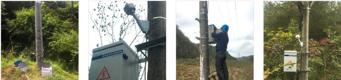
图为泰斗FTU北斗通信终端在贵州某地现场安装图
